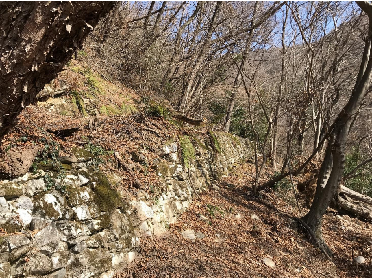
Figura A6. Muri a secco da sistemare lungo il sentiero che da Piangiovine conduce a Renscee.
